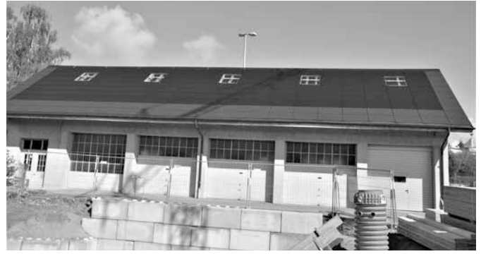
Zusätzlich zur Photovoltaikanlage auf dem Verkaufsladen liefert auch das Dach des Nachbargebäudes Strom für das Unternehmen
