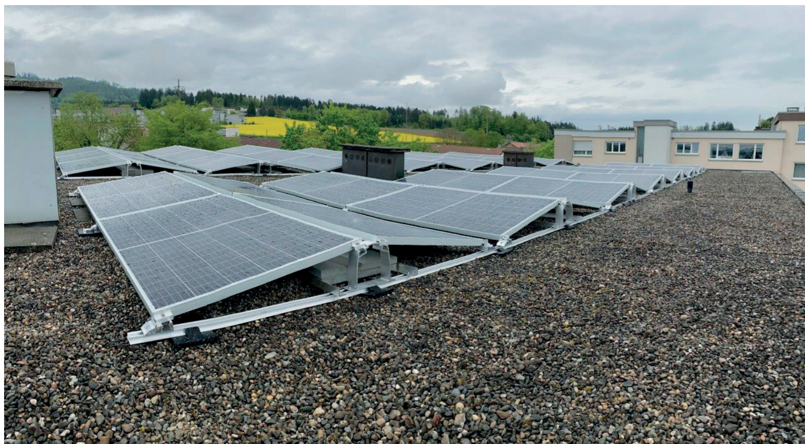
Durch den Eigenverbrauch amortisiert sich diese Photovoltaikanlage in 16 Jahren. Auf die Lebensdauer ergibt sich eine Rendite von knapp 2,5%.
